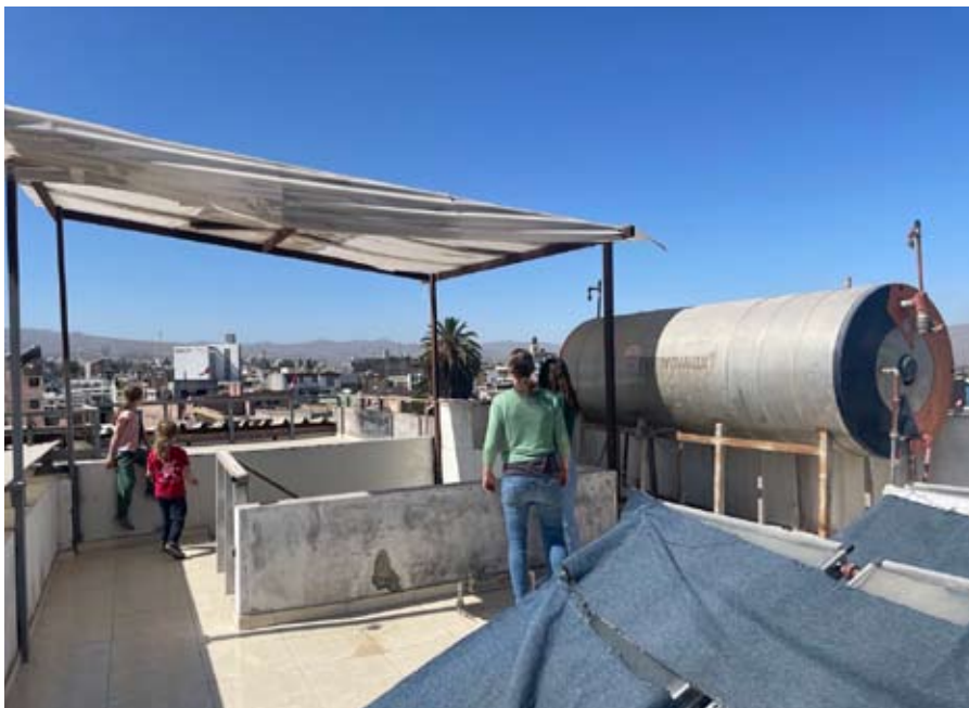
Vorhandene Solartherme zur Warmwasserbereitung
